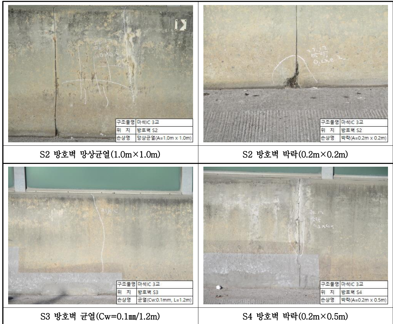
【사진 1.3.24】 방호벽 손상현황(계속)
