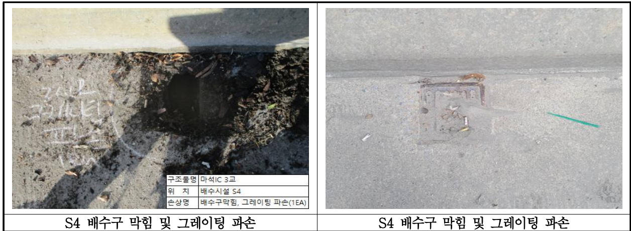
【사진 1.3.22】 배수시설 손상현황
