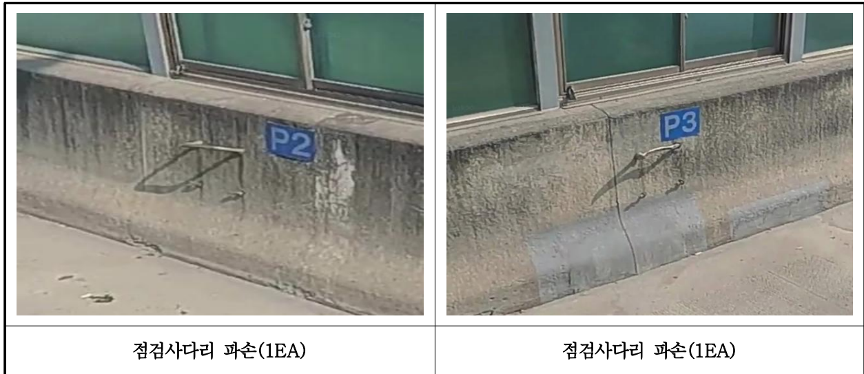
【사진 1.3.26】 교량 점검시설 손상현황
