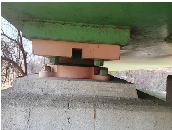
P1 받침 부식 임시조치(도장보수) 전 현황
