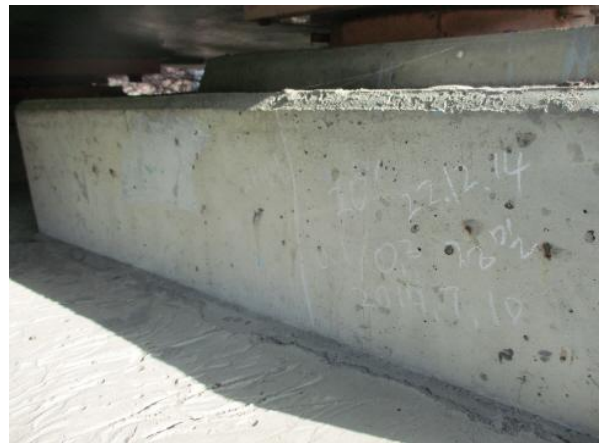
P3 Sh2 받침콘크리트 균열(Cw=0.1mm/0.3m)
